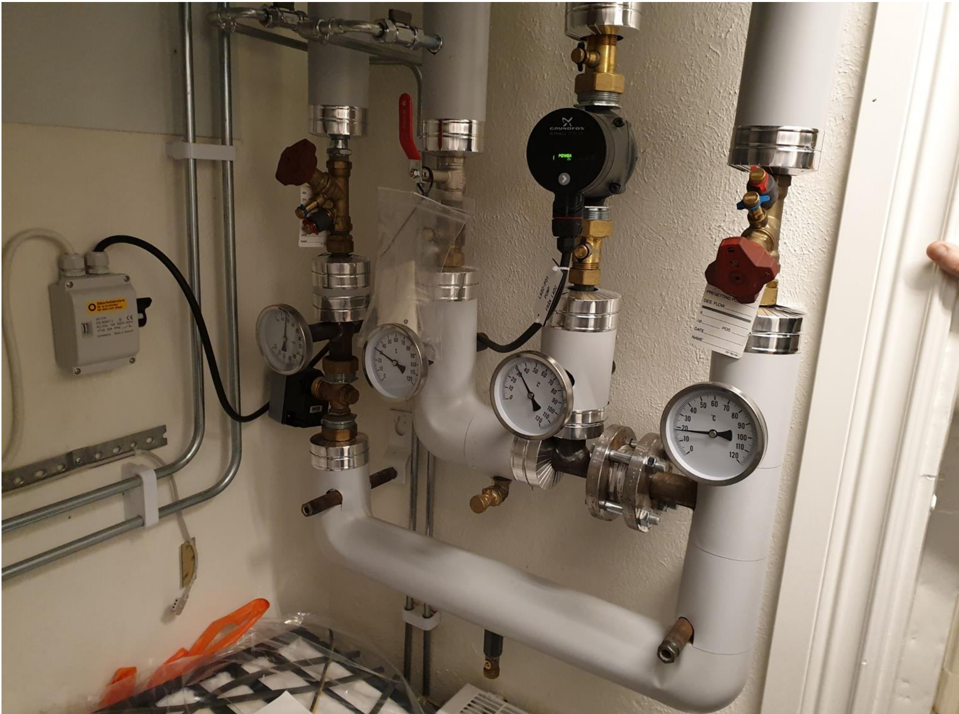
Sekundärledningar för spets till FTX vent-aggregat.
